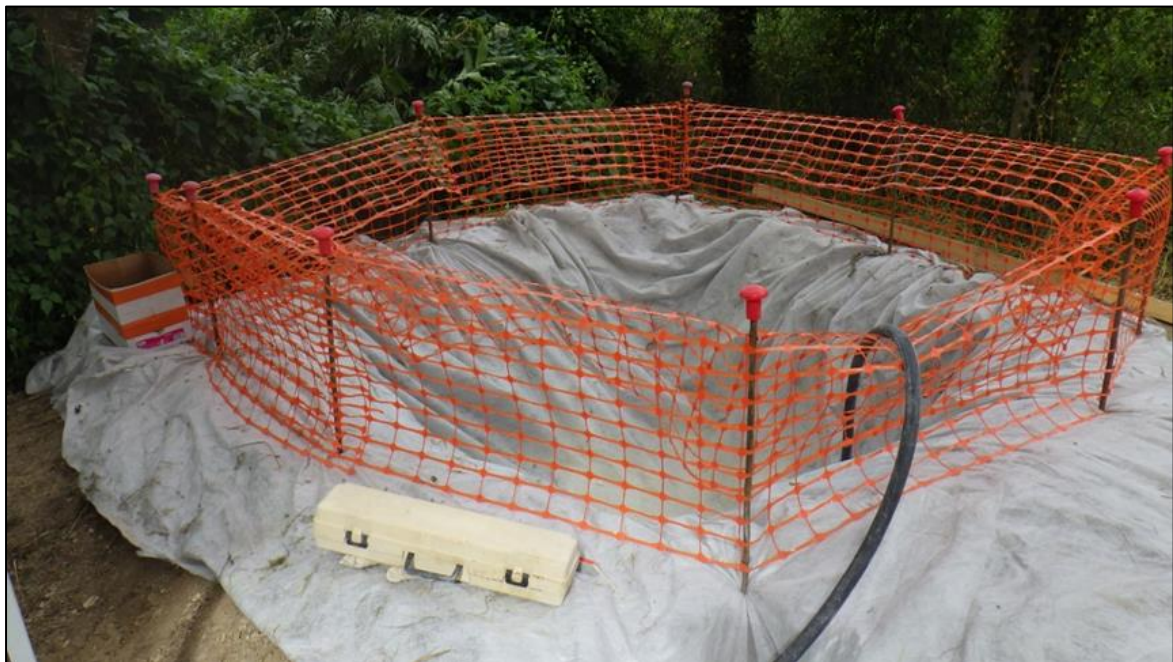
Figure 12 : Ligne 325 000 - Exemple d'un bassin de décantation provisoire pour les eaux d'exhaure de batardeaux
